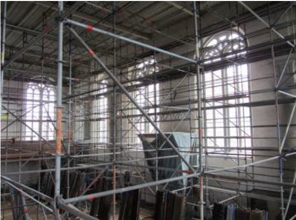
Hier noch einmal die Gerüste im Inneren der Kirche. Ein Wirrwarr aus Stangen und Streben. Zahlreiche Wasserschäden hatten die Decke unansehnlich gemacht.
